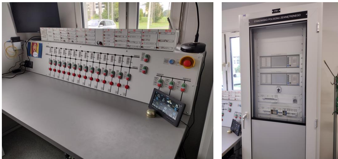
Pulpity zabezpieczające szkoleniowe, poligonowe linie i urządzenia nN i SN
